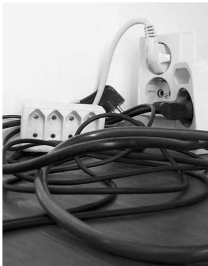
Das gleichzeitige Benutzen verschiedener Elektrogeräte muss auch im Altbau möglich sein
