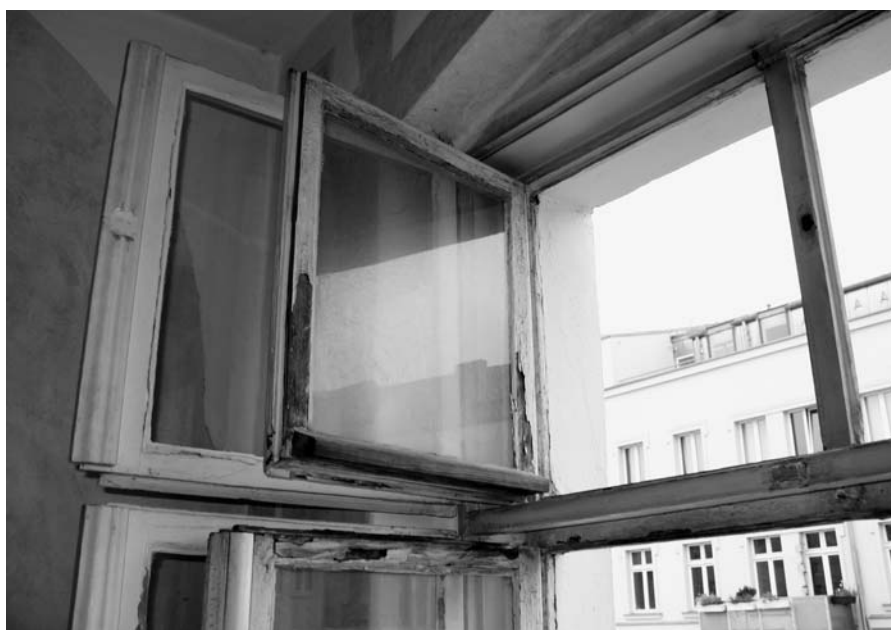
Auch wenn die Fensterfarbe von außen abblättert: Das Streichen der Außenseite von Fenstern bleibt grundsätzlich Sache des Vermieters. Zu den Schönheitsreparaturen im Sinne des § 28 Abs. 4 Satz 3 der II. Berechnungsverordnung gehört nur das Streichen der Fenster von innen.
