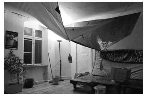
Die Mieter/innen müssen gegen die Nässe in den Wohnräumen Folien und Planen spannen.
