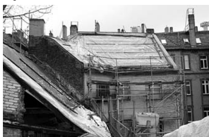
Abgerissenes Dach des Gebäudes Almstadtstraße 24.
