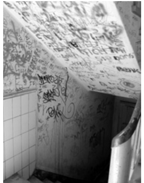
Die mit Graffiti übersäten Treppenhäuser der Gebäude am Grazer Damm sollen nicht saniert werden.
