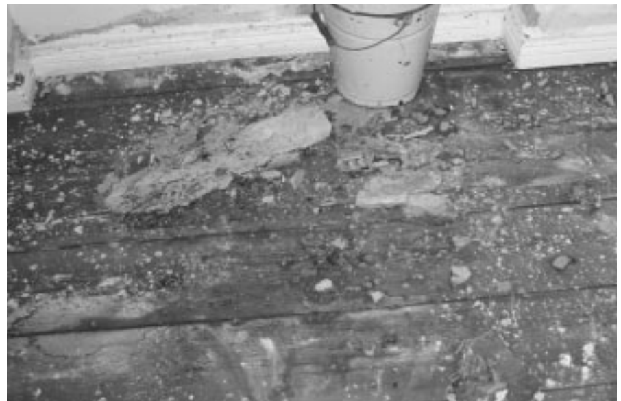
Heruntergefallener Stuck durch Wasserschaden Foto: Archiv
