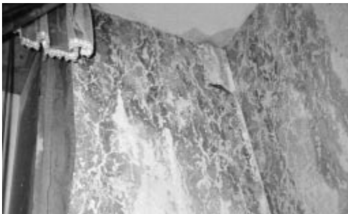
Undichte Stellen im Dach aufgrund eines unsachgemäß installierten Balkons lassen das Wasser die Wände hinablaufen.
