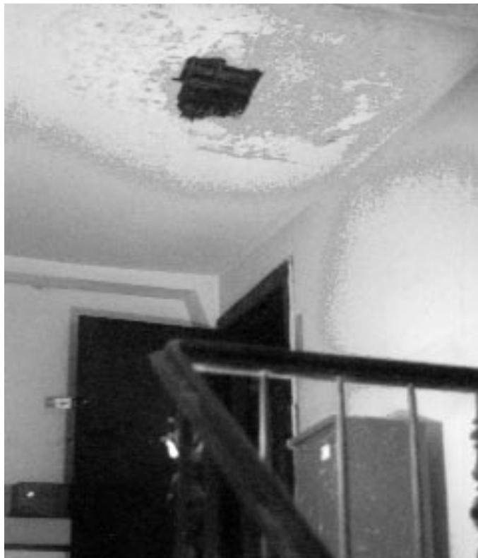
Wasserschaden seit 1991 wird nicht behoben
