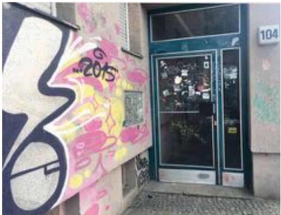
Wenn der Gesamteindruck von Treppenhaus und Eingangsbereich eine Renovierungsbedürftigkeit nahelegt, befinden sich diese in überwiegend schlechtem Zustand; ein besonders schlechter Zustand ist nicht erforderlich. Foto: nmp
