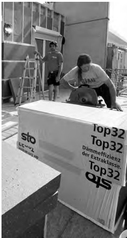
Wärmedämmung spült Geld in die Kassen der Dämmstoffproduzenten. Aber die Fragen zur Entsorgung der Dämmplatten und zu den Problemen des Brandschutzes sind bisher ungeklärt.
