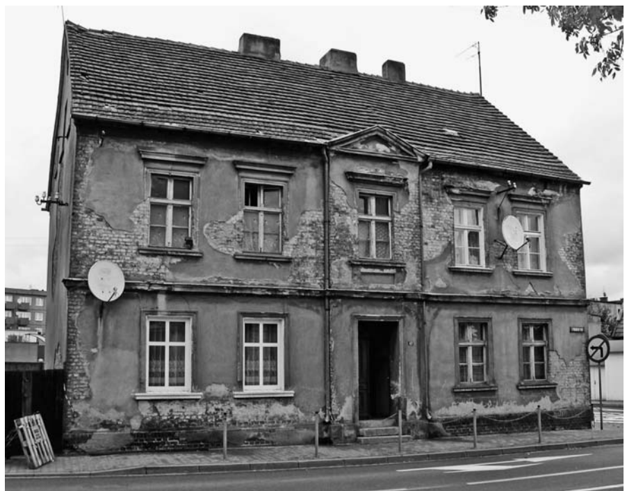
Viele Häuser und Sozialwohnungen in Polen befinden sich in einem desolaten baulichen Zustand. Foto: Altbau in Gostyn.
